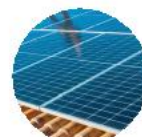
Panneaux solaires thermiques et photovoltaïques
